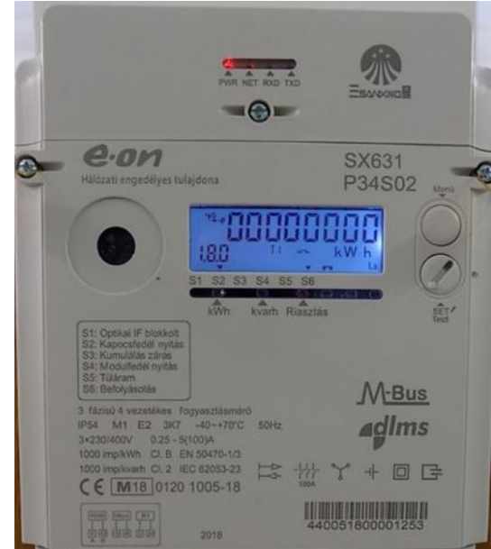
3 fázisú, típusa: SX631 P34S02 3x5-100 A Kommunikáció: 2G Felbontás: 8 egész 0 tized
